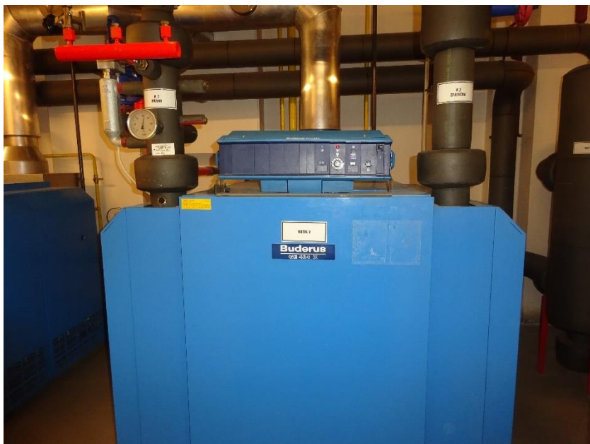
Suterén Administrativní budovy – plynová kotelna
