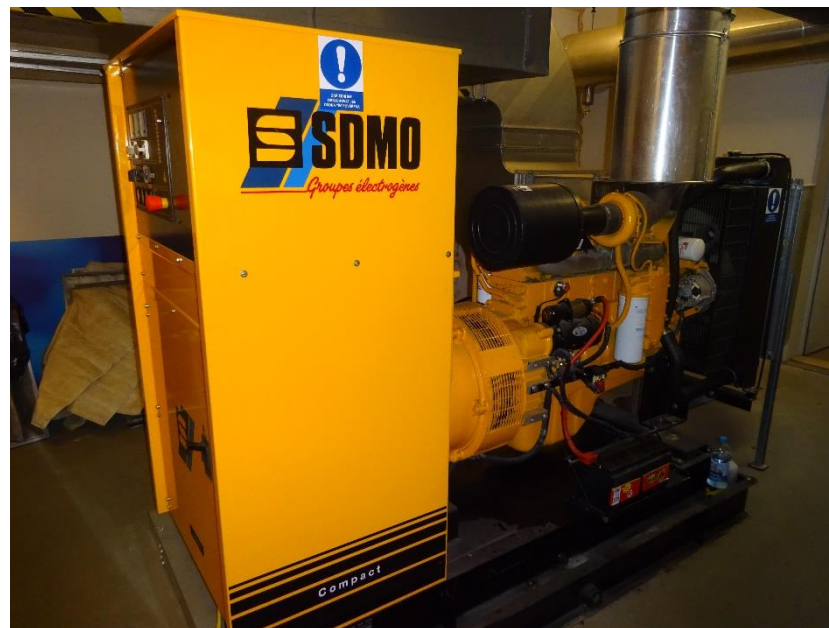
Suterén Administrativní budovy – záložní dieselový agregát
